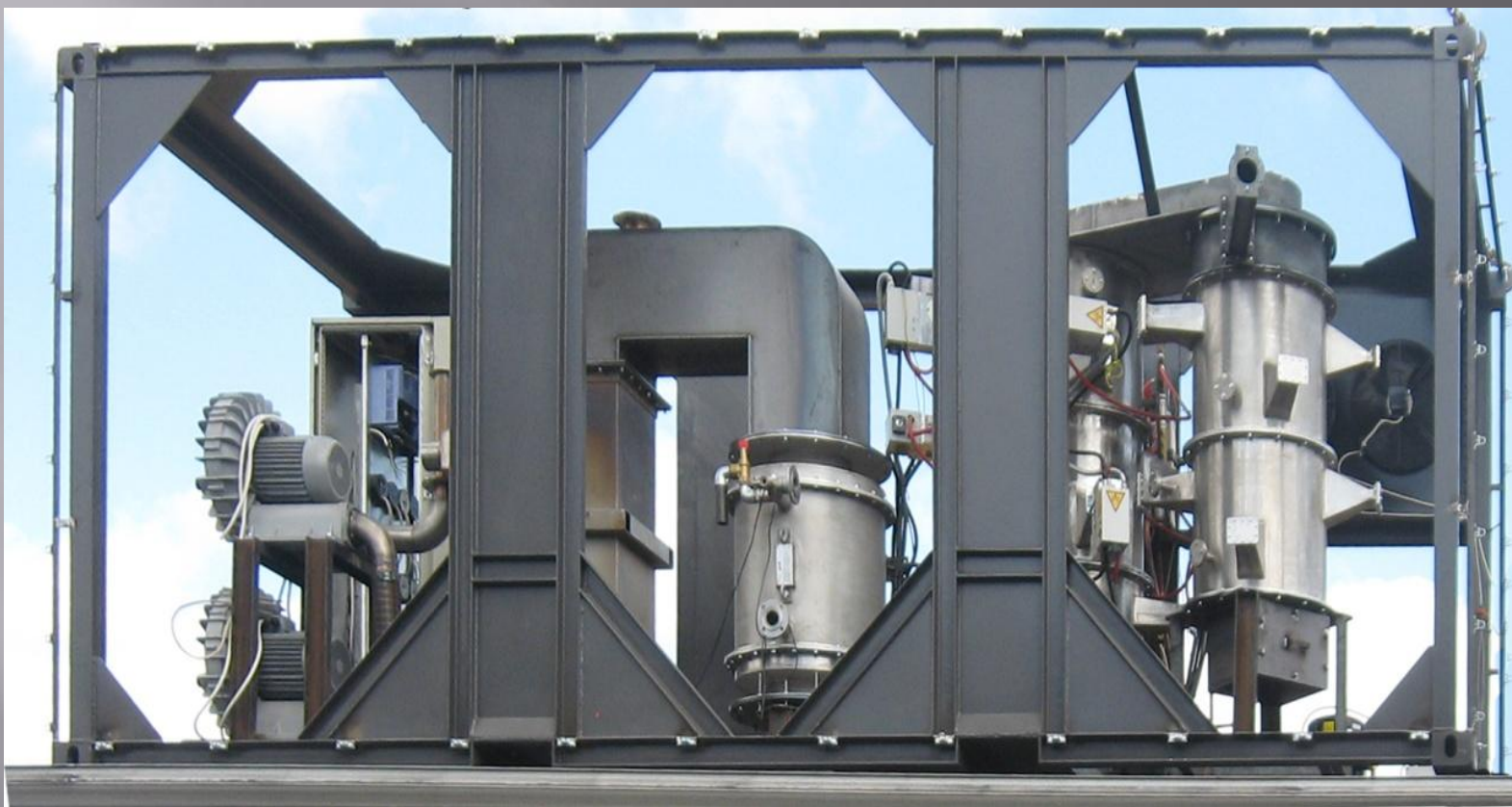
Konstrukcja reaktora ATON MOS – zamontowanego w kontenerze wraz z innymi elementami instalacji.
